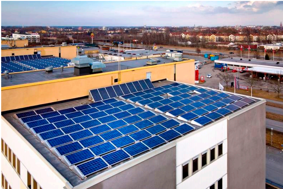
Figur 12 Solceller på platt tak i Örebro.
